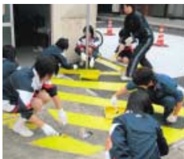
▶消防庫前の駐車禁止場所の塗り替え(中区にて)
