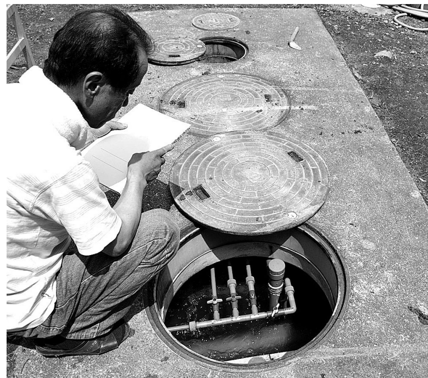
定期的に点検しています ― 小型合併処理浄化槽 ―
