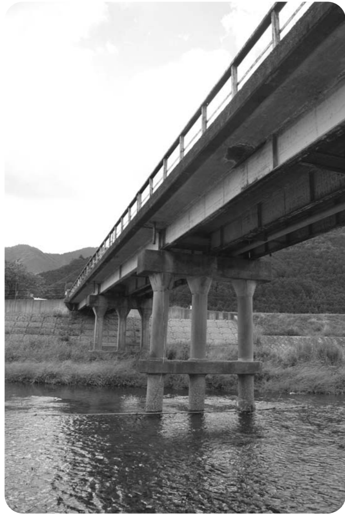
修繕が待たれる郷領橋
