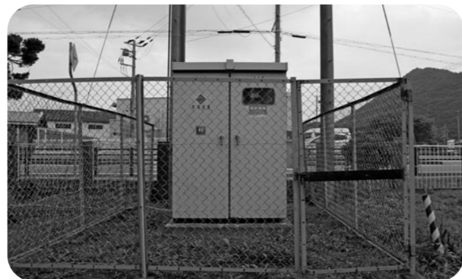
一刻も早い増設を キュービクル
