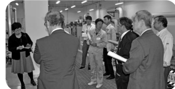
清掃の行き届いた施設内 —岸上浄水場—
