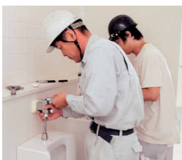
▲水漏れがなくなり快適に
