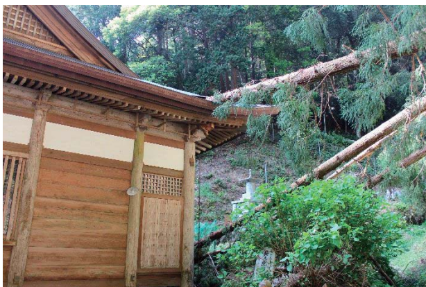
楊柳寺本堂(柳山寺)の倒木被害
