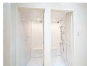
【シャワー設備】
