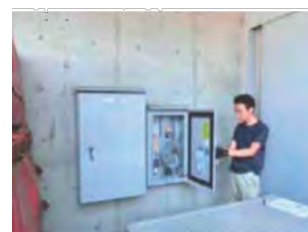
【可搬式発電機取付口】
