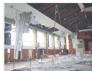
[東日本大震災における天井落下]
