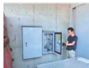
[可搬式発電機取付口]
