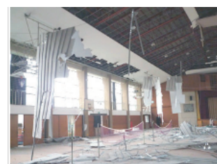
[東日本大震災における天井落下]
