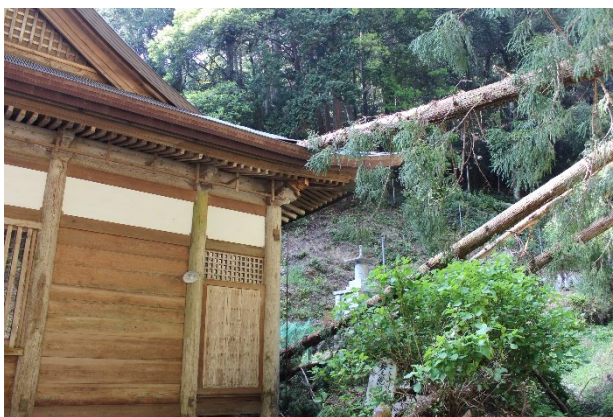
楊柳寺本堂(柳山寺)の倒木被害
