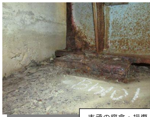
支承の腐食・損傷
