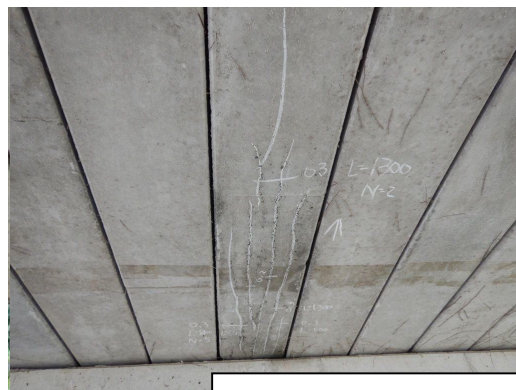
PC 橋の主桁のひび割れ
