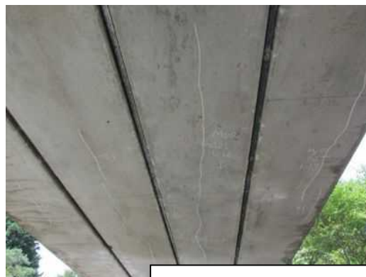
PC 橋の主桁のひび割れ
