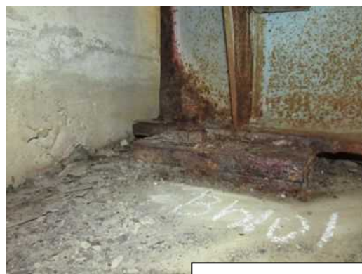
支承の腐食・損傷
