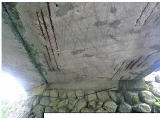
床版橋のコンクリートの剥離
